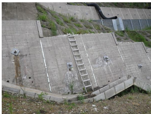
写真 2 のり面の変状状況
