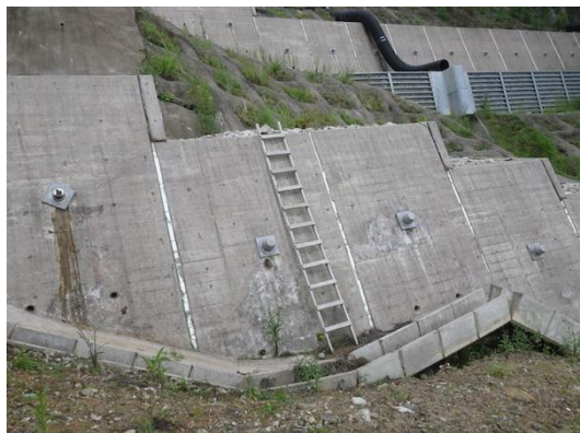
写真 2 のり面の変状状況
