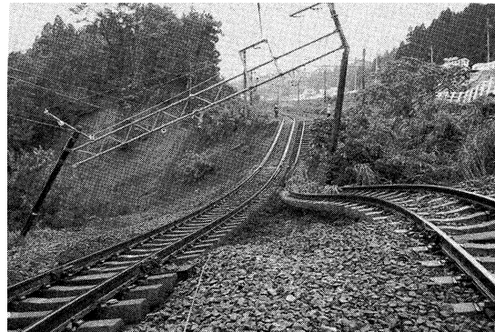
JR 上越線における盛土の被災事例 2)
