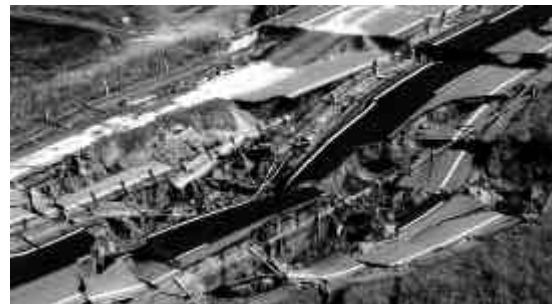
関越自動車道における盛土の被災事例 3)
