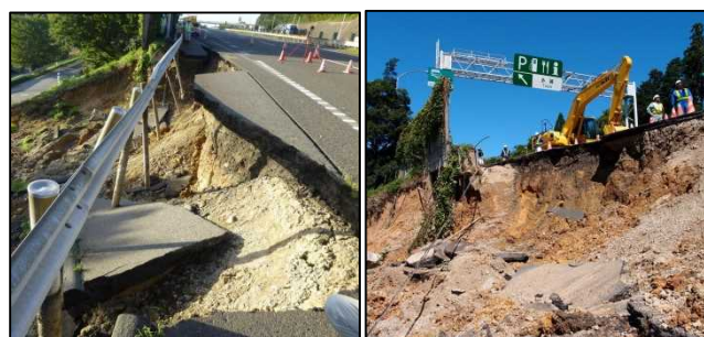
写真-3 災害状況① (本線路肩側)
