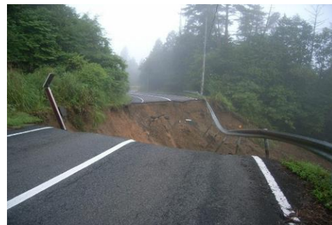
写真-2 豪雨による盛土部の崩壊
