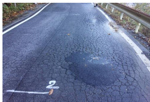
写真-1 補修済み箇所における異常の再発とその補修例
