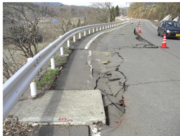
写真-1 埋設管の影響による道路崩壊、長野県北部地震(2011)
