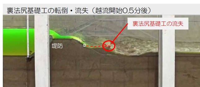
写真-1 堤防（裏法尻基礎工）損壊時の流況及び洗掘状況
