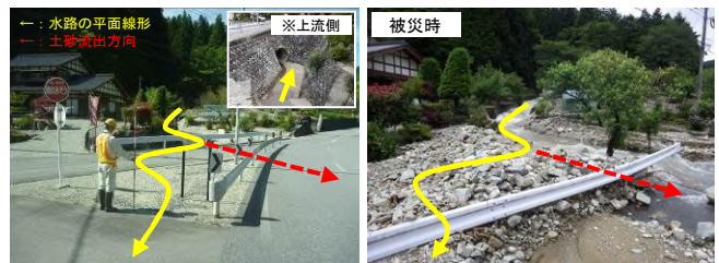
写真-7 S字線形が原因の土砂流出（流域 49）
