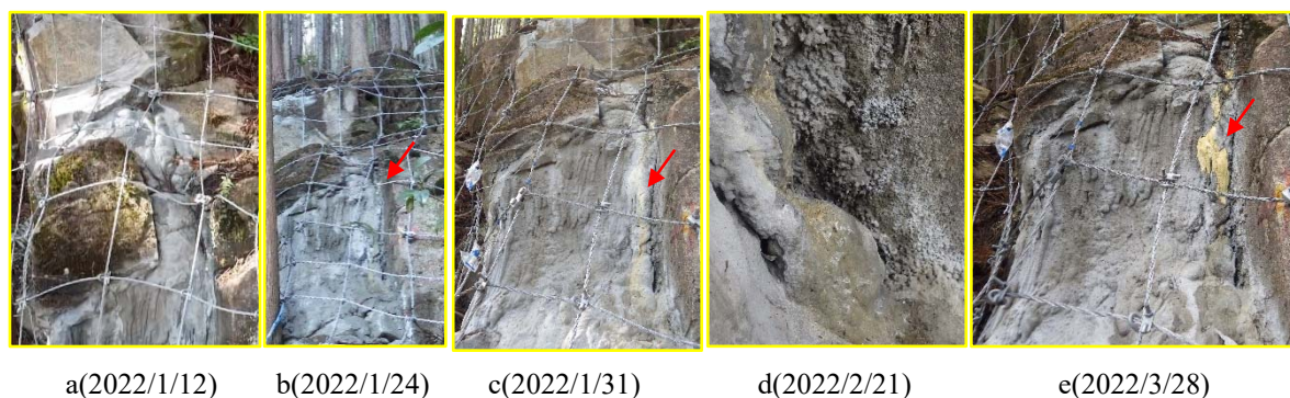
写真-9 ②の施工箇所での表面被覆材の剥落
