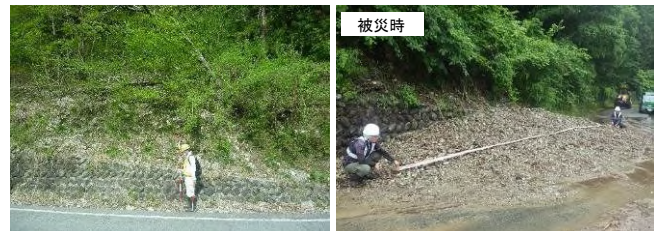
写真-8 平常時に流水が無い集水地形の土砂流出（流域 16）
