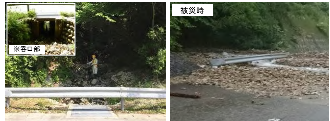
写真-6 横断排水管の呑口閉塞による土砂流出（流域 107）
