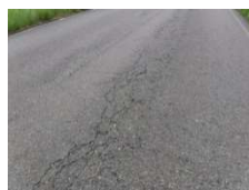
図-2 亀甲状亀裂
