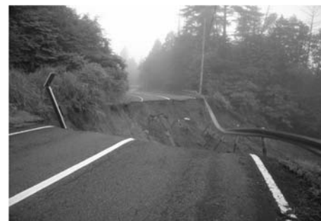
平成21年7月31日～8月3日豪雨により発生した (一)飛騨木曾川公園線(御嵩町)の盛土崩壊
