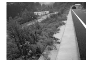
補強土壁天端(トンネルに向かって壁の勾配がゆるくなり路面と離れる)
