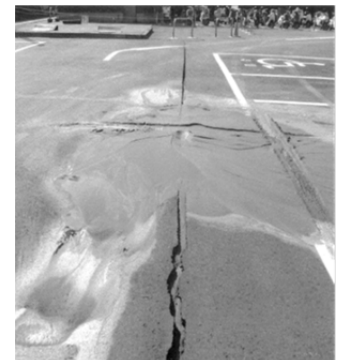
写真-1 道路のひび割れ
