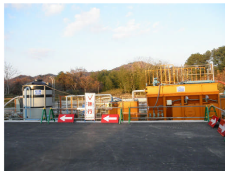
写真 4-3 ヒ素処理設備
