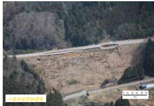
写真-1 谷埋め盛土崩壊地区(その1)
