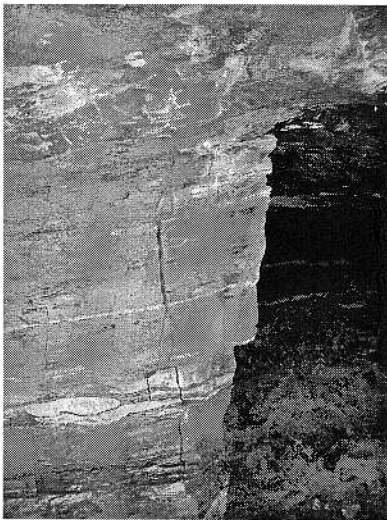
1) 残柱の亀裂の進展
