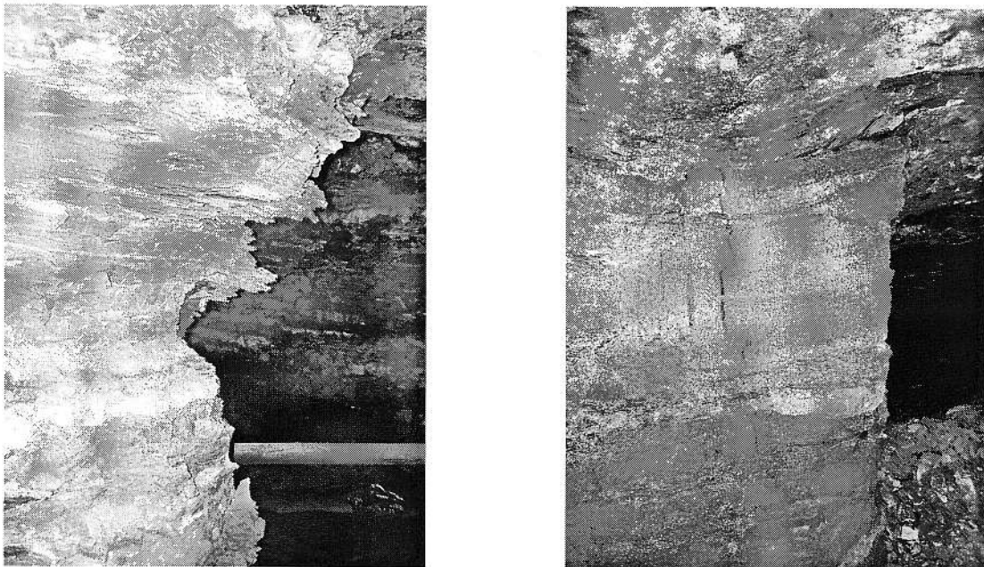
図-4 乾燥収縮による剥離現象
