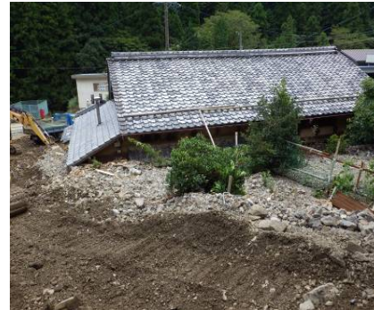
写真-7 未倒壊家屋
