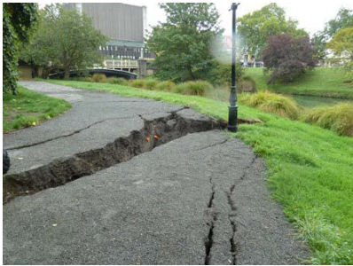
写真 3 Avon 川沿いの流動被害
