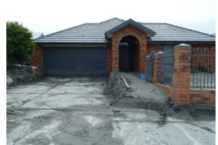
写真 7 Bexley の液状化被害
