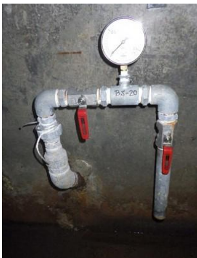
写真-1 浸透流観測孔及びブルドン管圧力計
