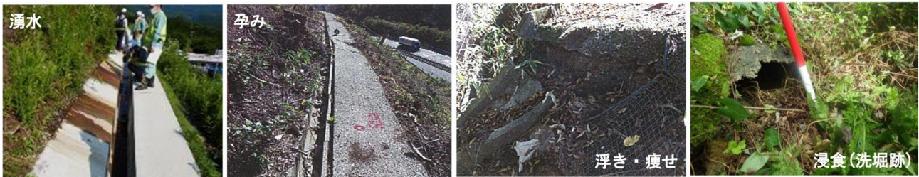
図-8 災害履歴のある東海層群切土のり面で確認される変状の例
