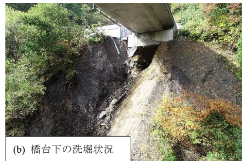
写真-1 被災状況
