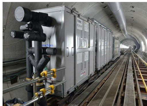
写真-1 凍結設備
