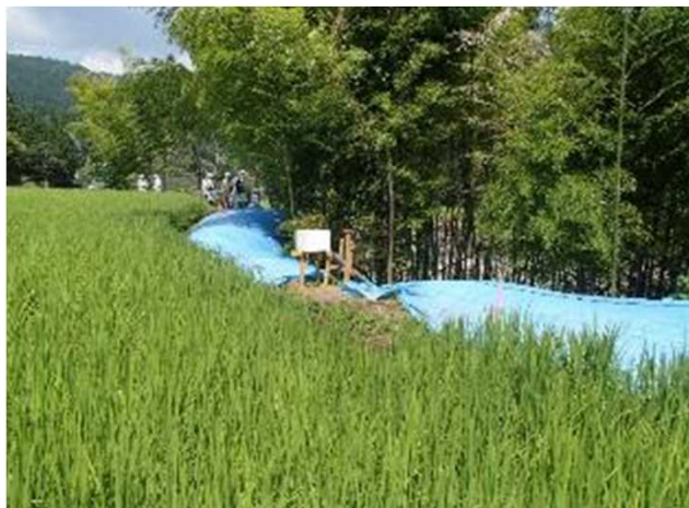
写真4 頭部滑落崖状況
