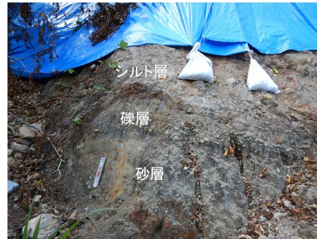
写真3 崩壊地を構成する地層 (スケールは30cm)
