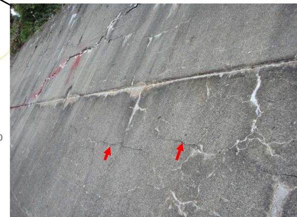
コンクリート擁壁内の明瞭な亀裂が確認された箇所よりも東側に確認される亀裂
