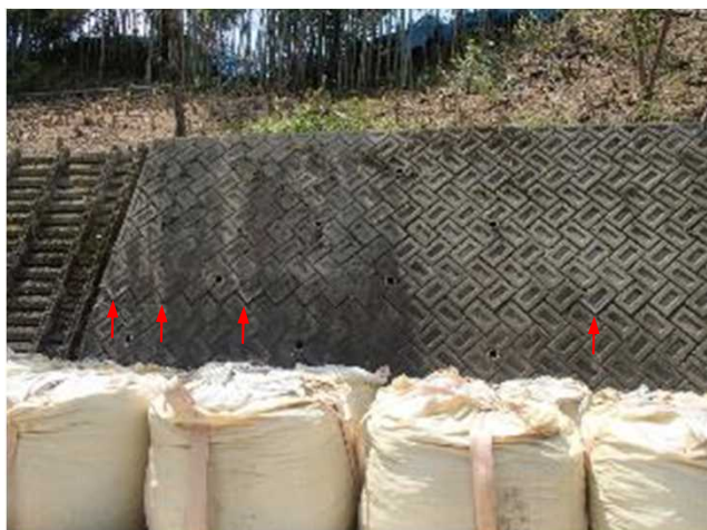
写真6 擁壁のはらみ出し
