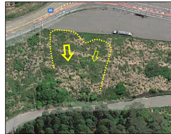
写真-2 崩壊前の盛土のり面
