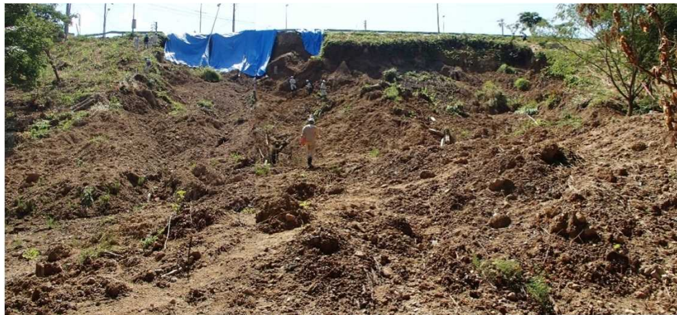
写真-1 崩壊地全景
