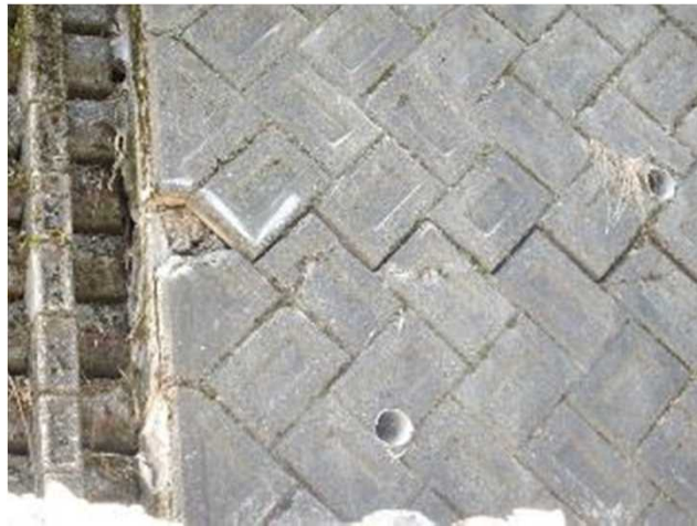
写真7 擁壁のはらみ出し
