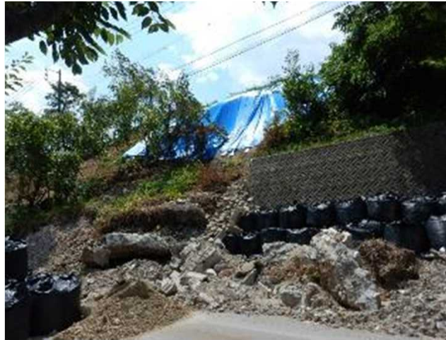
写真1 崩壊状況 ブロック積擁壁が損壊
