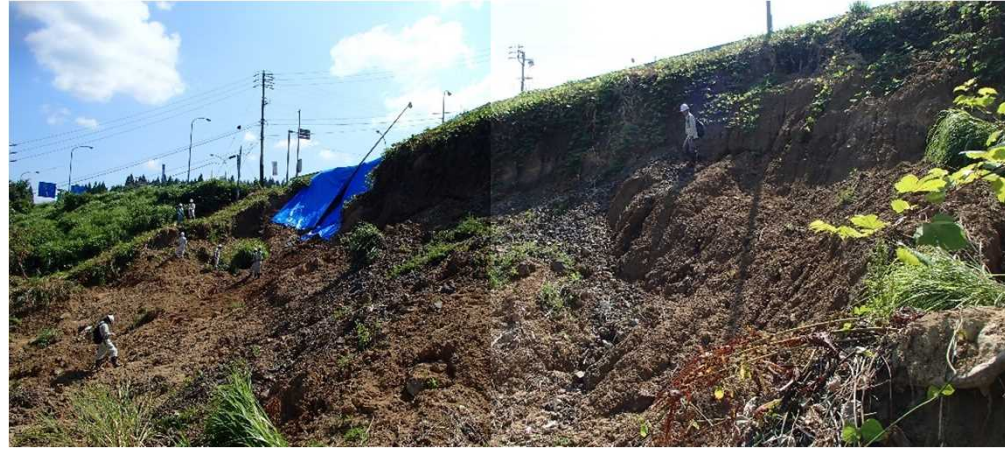
写真-3 崩壊地頭部滑落崖
