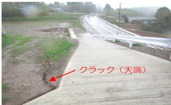
写真 8 天端のクラック状況
