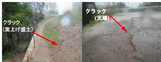
写真 11 クラックの状況
