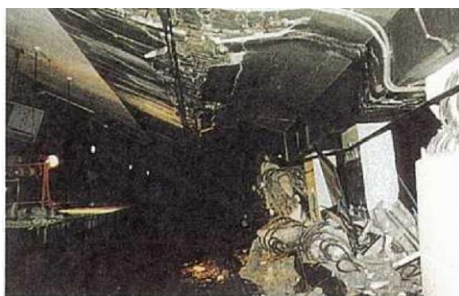
図 2 大開駅被害状況 2)
