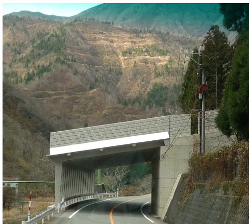
写真-5 九頭竜川沿川は崩れやすい いたる所に落石防護工がある
