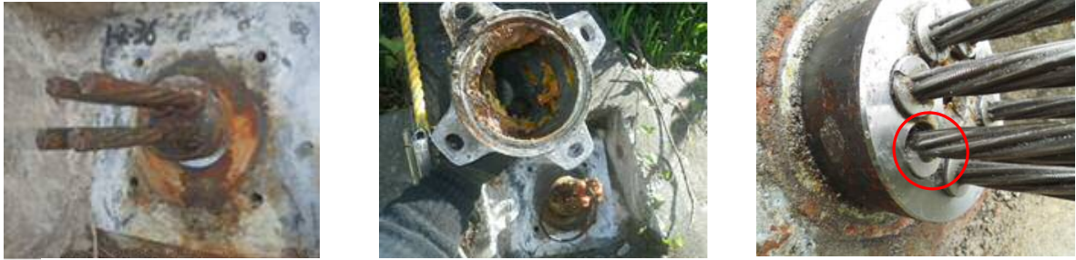
① 定着具に軽微な錆 ②防錆油の充填不足(漏れ) ③くさびの欠落
