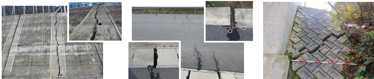
写真-1 切土末端擁壁クラック
